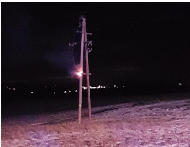
Brand eines Strommasten in Mörtersdorf Richtung Loibersdorf am 3. Jänner 2019
